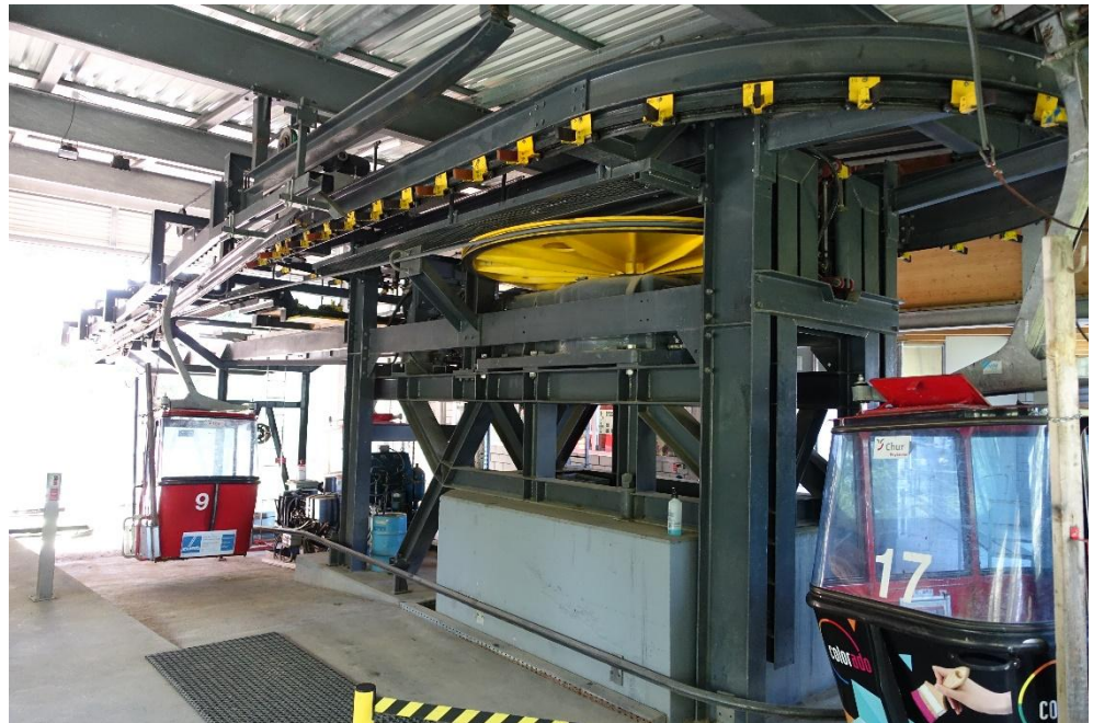
Abb. 6 Kabinen im Umlauf der Talstation Känzeli
